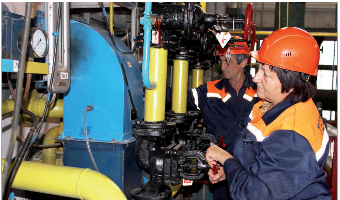
Оператор котельной 5-го разряда Т.А. Барзюлевская, слесарь КИПиА 5-го разряда С.С. Андрияшин, котельная ул. Хрусталева, 66-А
