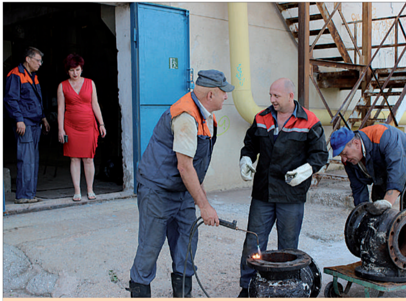
На котельной Хрусталева, 66а
